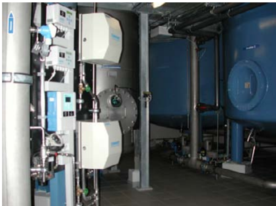
Anlage zur Aufbereitung von Quellwasser. Beispiel aus Röschenz.
